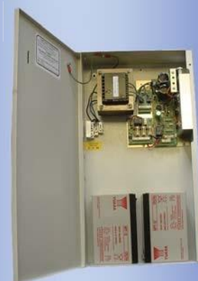
Вспомогательный модуль питания обеспечивает длительную работу при отключении основного питания.
